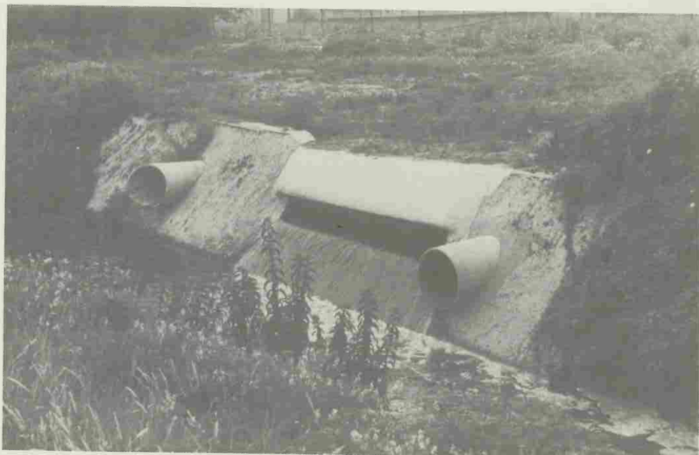
Lo scarico del depuratore di "Casa del Lupo"
