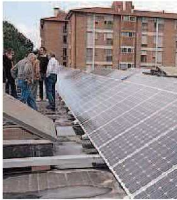
PANNELLI Uno dei numerosi impianti fotovoltaici della Valdera
