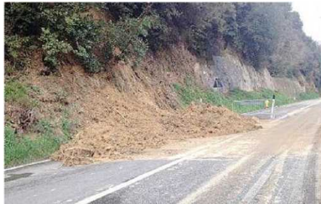
Un'altra frana ha interessato la strada provinciale Francesca
