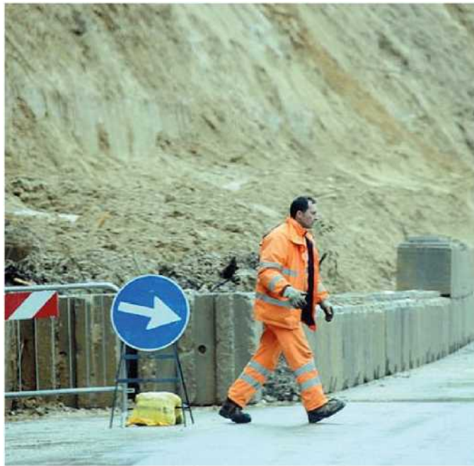
La frana sulla strada provinciale Francesca (foto Silvi)
