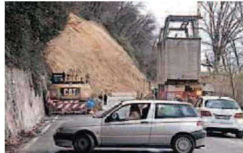
COLLINA FERITA Il fronte franoso sulla strada provinciale Francesca
