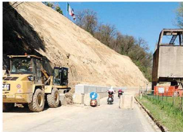
La frana sulla strada provinciale Francesca
