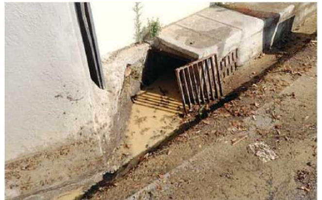
Le fogne che hanno provocato il problema di allagamento
