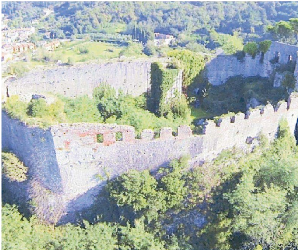
Il degrado fuori e dentro la Rocca di Ripafratta
