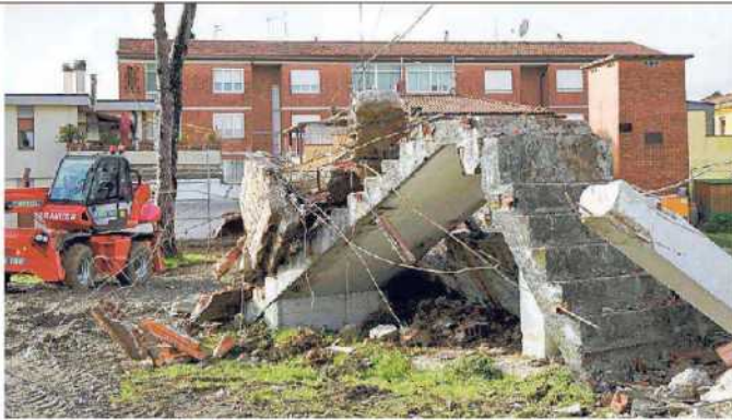
L'ex scalinata che portava alla curva del velodromo rimasta in piedi (Fotoservizio Franco Silvi)
