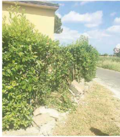
I danni al muro di recinzione della villetta
