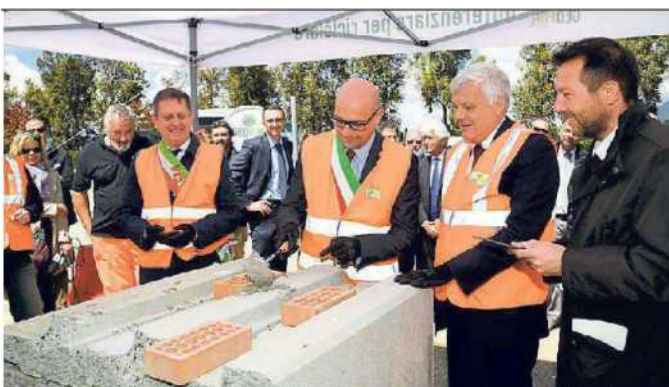
Il ministro Galletti e i sindaci alla posa della prima pietra per la costruzione dell'impianto
