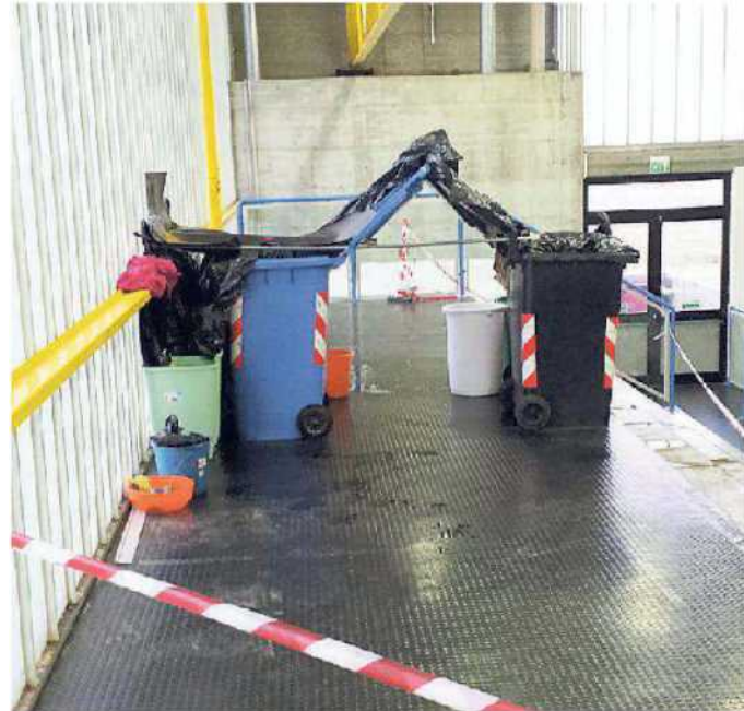
Bidoni per raccogliere le infiltrazioni al palazzetto dello sport di Calcinaia
