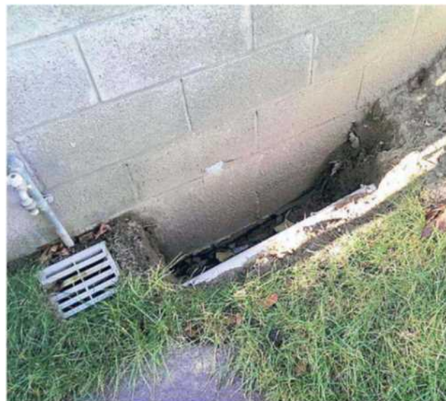
Lo spazio in cui Acque Spa avrebbe dovuto installare il nuovo contatore
