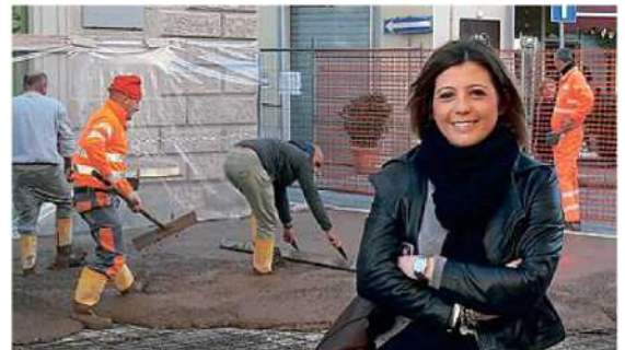
SUL CANTIERE La sindaca Giulia Deidda in piazza Matteotti mentre viene colato e steso l'asfalto architettonico di fronte alla biblioteca
