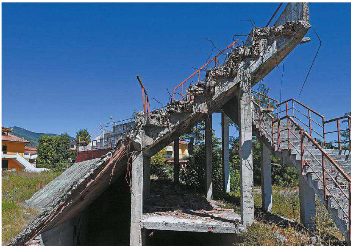
Lo scheletro parziale dell'anello e delle tribune del velodromo di Fornacette (foto di Franco Silvi)
