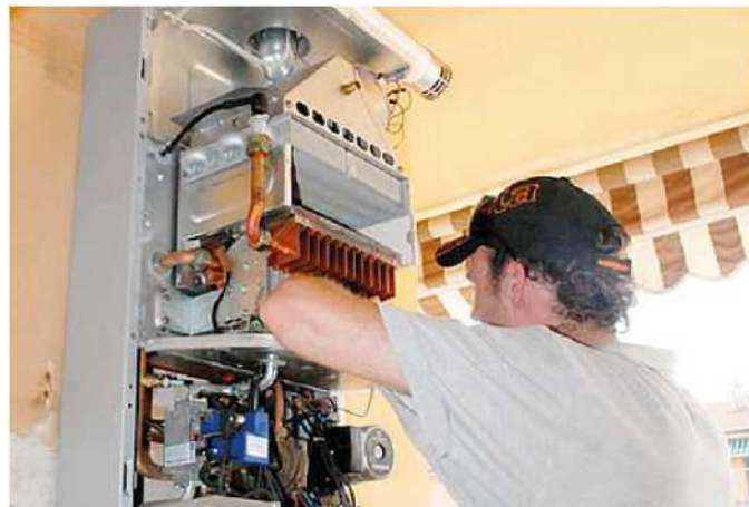
Un tecnico mentre effettua controlli ad una caldaia (foto d'archivio)
