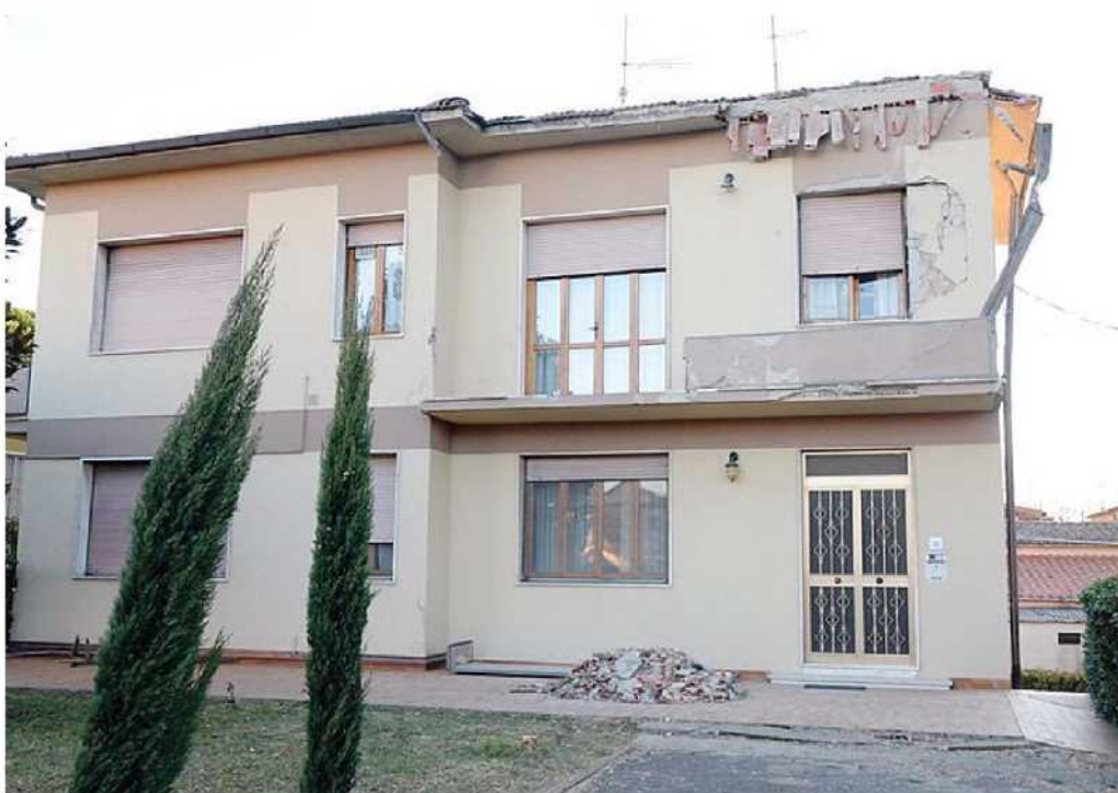
I danni subiti da un'abitazione a causa del vento forte (foto F. Silvi)
