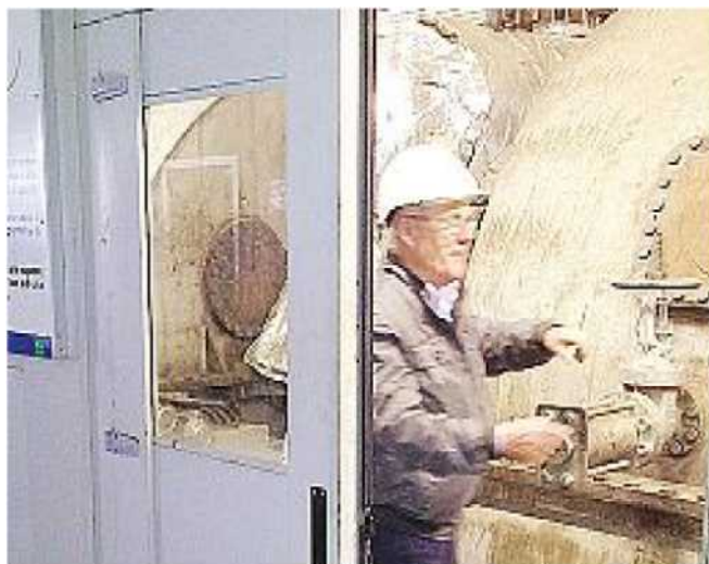
RISORSE Grandi partner per un progetto che punta a dare valore alle potenzialità geotermiche del nostro sottosuolo
