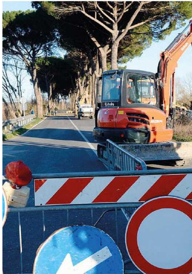
Danni per la tempesta di vento nel comune di Calcinaia
