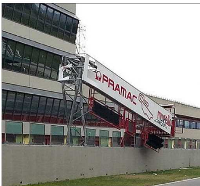
■ L'AUTODROMO DEL MUGELLO. Il circuito di Scarperia, dove ogni anno per il Gp Italia affluiscono decine di migliaia di persone, devastato dal vento. Crollati pezzi del controsoffitto della copertura, pannelli pubblicitari e duecento alberi
